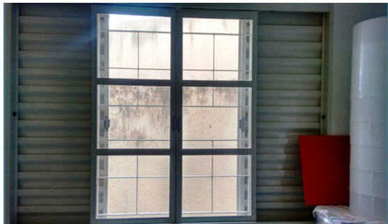
Figura 4. Janelas da área de processamento de gelados comestíveis sem telas milimétricas para proteção contra pragas (Estabelecimento C).
