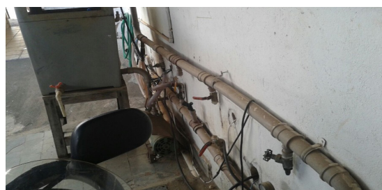
Figura 2. Instalações elétricas aparentes (Estabelecimento A).
